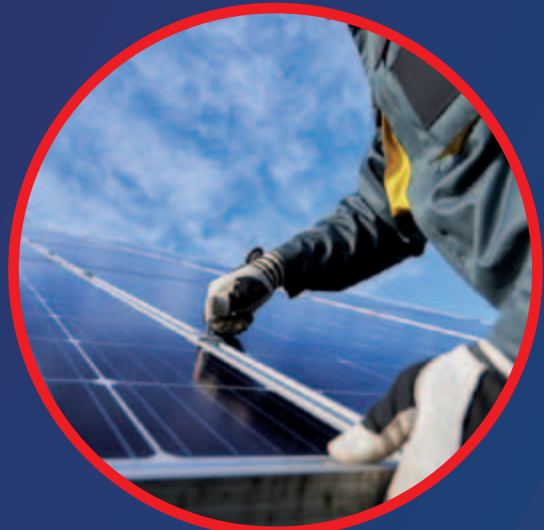
INSTALACIONES ELÉCTRICAS Y FOTOVOLTAICAS
