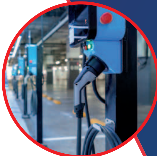
INSTALACIONES PUNTO DE RECARGA DE VEHÍCULO ELÉCTRICO
