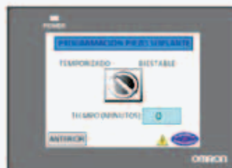
SUBMENU DE UNA BOMBA SOPLANTE PARA PROGRAMAR CONFIGURACIÓN DEL PIEZOELECTRICO Y TIEMPO DE FUNCIONAMIENTO.
