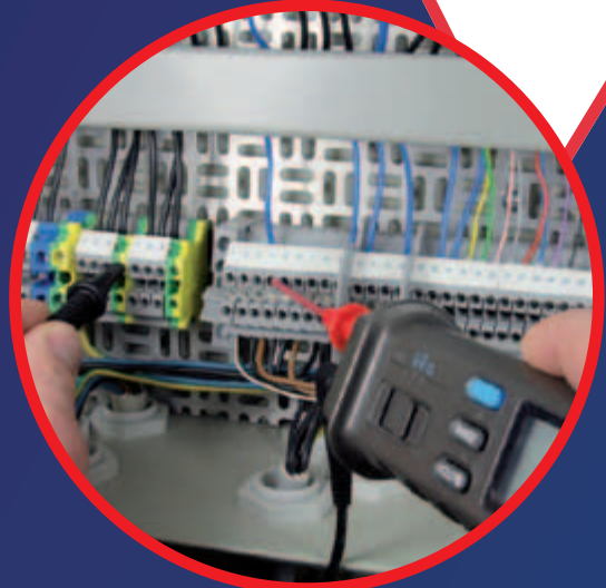
FABRICACIÓN DE CUADROS ELÉCTRICOS
