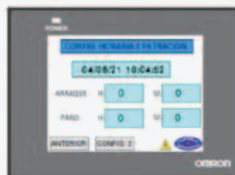
SUBMENU DE LA FILTRACIÓN PARA REALIZAR PROGRAMACIÓN HORARIA MEDIANTE RELOJ.
